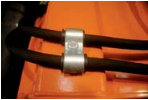
Фотография: Крепление гидравлических проводов
